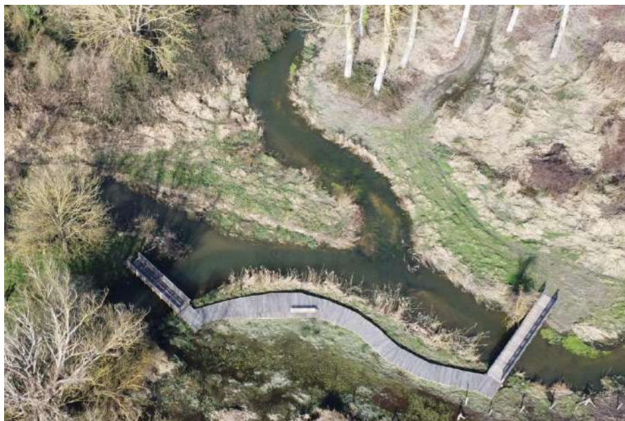
Figure 29 : Vue après travaux, le 3 mars 2025, la section d'écoulement est restaurée (source : SBNM)
