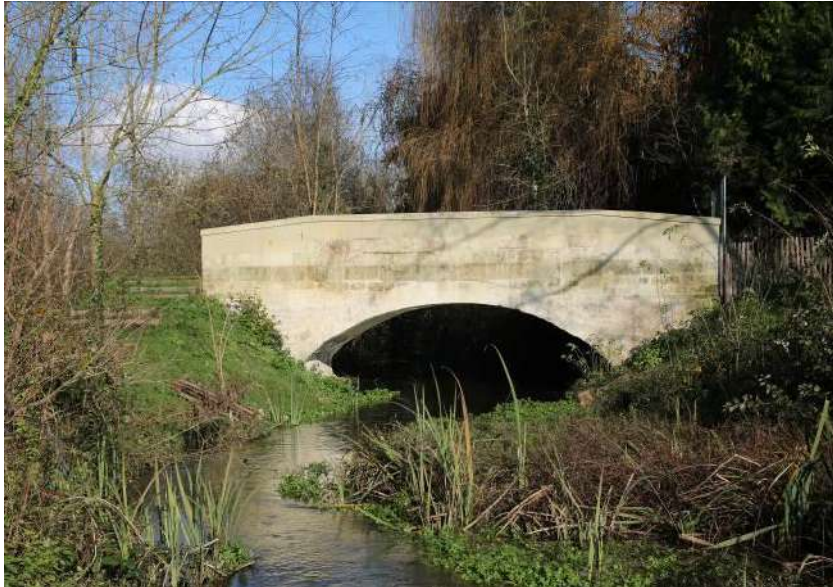
Figure 32 : Vue du pont avant et après travaux de restauration (photo PNR LAT)
