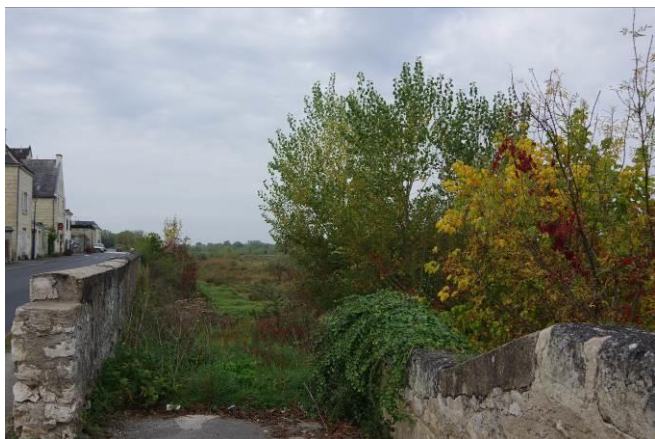
B.1. Abandon progressif de l'entretien des ouvrages des rives ligériennes (Souzay-Champigny)
