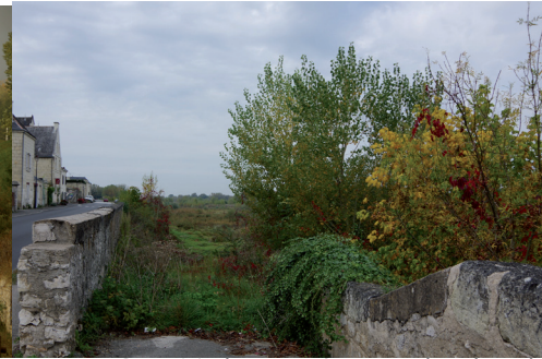
Saint-Mathurin-sur-Loire : abandon du pied de la levée
