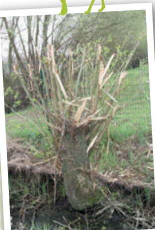
Branches éclatées suite au passage d'une épareuse.
